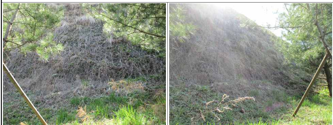
② STA.0-20 1단 녹생토유실, 누수 ⇨ 주의관찰
