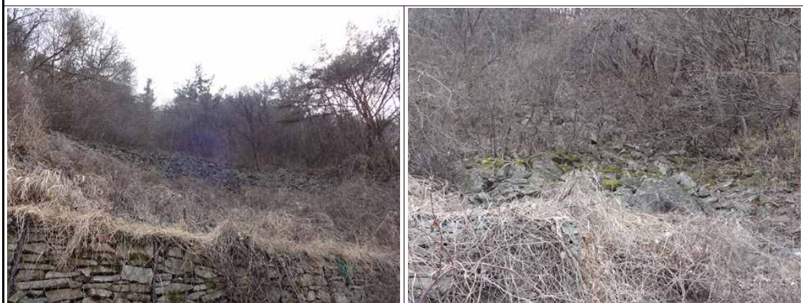
② 정면 STA.+45 자연사면 암괴 다수 ⇨ 주의관찰
