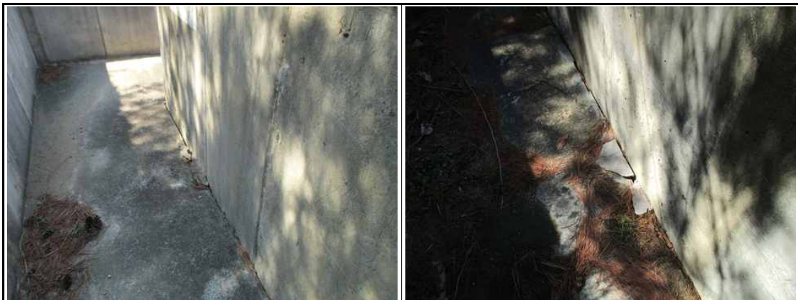
① STA.0-20 갯문배면 배수로 파손, 이격 ⇨ 주의관찰, 정비
