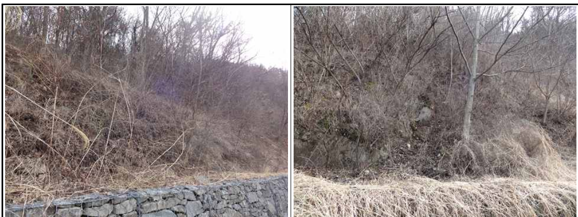
① 정면 STA.-10~+40 자연사면 표층유실우려 ⇨ 주의관찰
