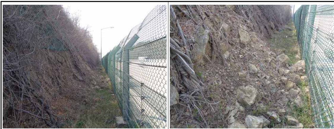
㉠ 87.27K 1단 충전물유실, 하부퇴적 ⇨ 주의관찰 후 합벽 (A=6m*15m)
