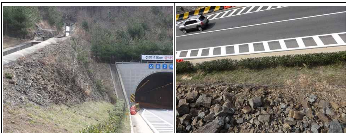
① STA.0+110 1단 이완암, 뜯돌 ⇨ 주의관찰 후 방호벽
